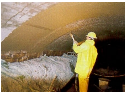
Aplicación en spray de VANDEX UNI MORTAR 1 Z en dos capas, total 40 kg/m 2 (20mm)
